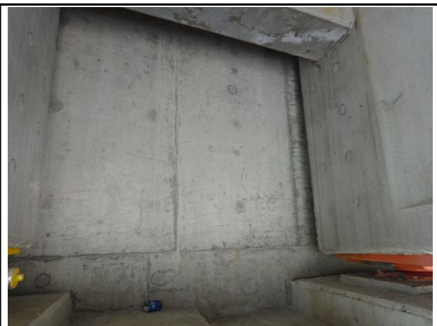
교대 원주방향 A1 균열 CW=0.2mm
