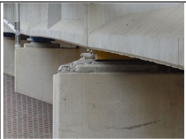
교각 서울방향 P3 코핑부 상면 폐콘크리트 퇴적
