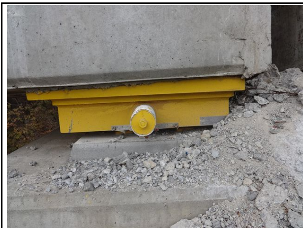
교각 원주방향 P3 코핑부 상면 폐콘크리트 퇴적
